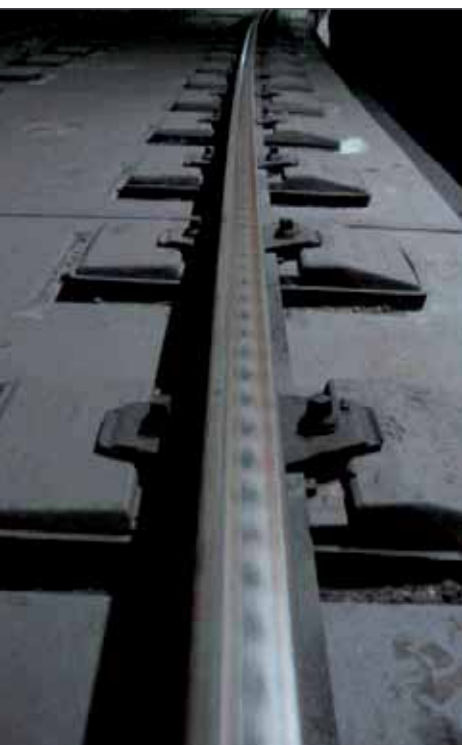
Vista de un carril con desgaste ondulatorio de onda corta.
